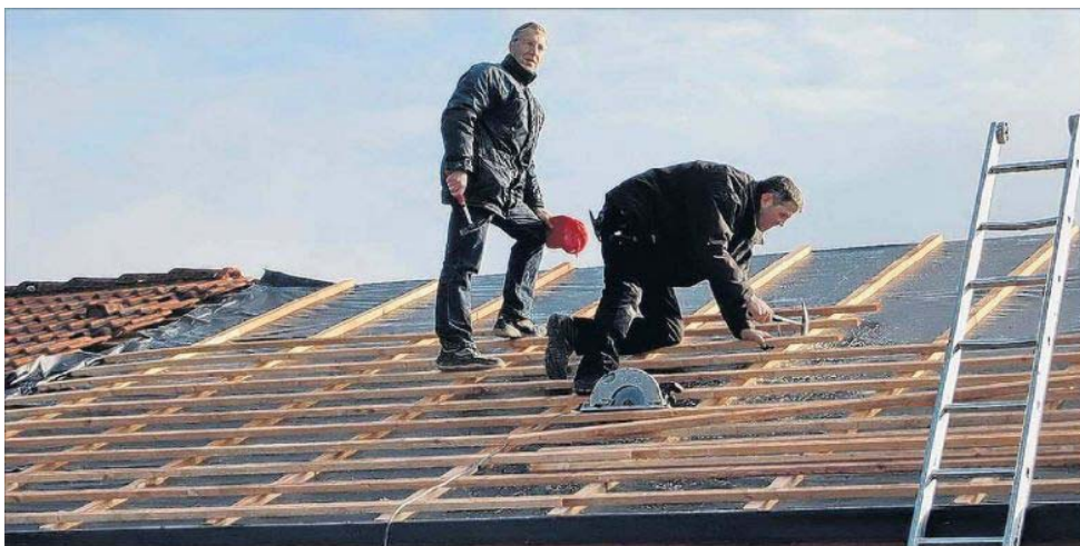
Aufs Dach stieg TuS-Tennisobmann Volker Frank (stehend) dem Neubau, um dem Fachmann beim Dachdecken ein wenig zur Hand zu gehen. Fotos: TuS Lotte
